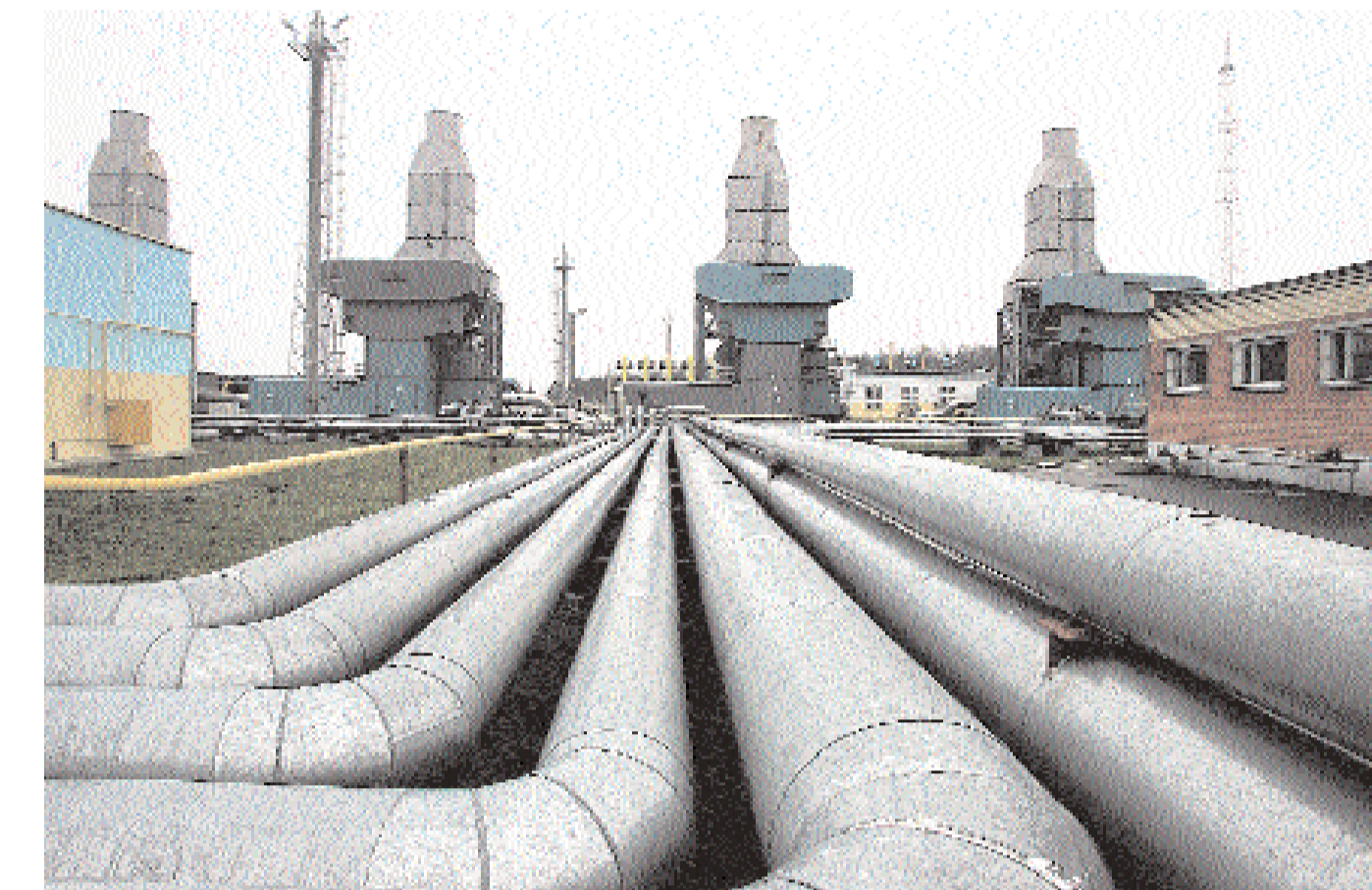
Eine Kompressorstation an der Gasleitung in der Nähe von Minsk, der Hauptstadt von Weissrussland.
